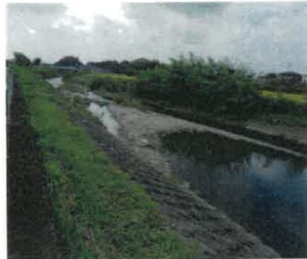
写真＝新川の堆積と護岸の状況 （富士見町から針谷町方面）
