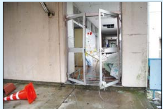
施錠されていた扉
