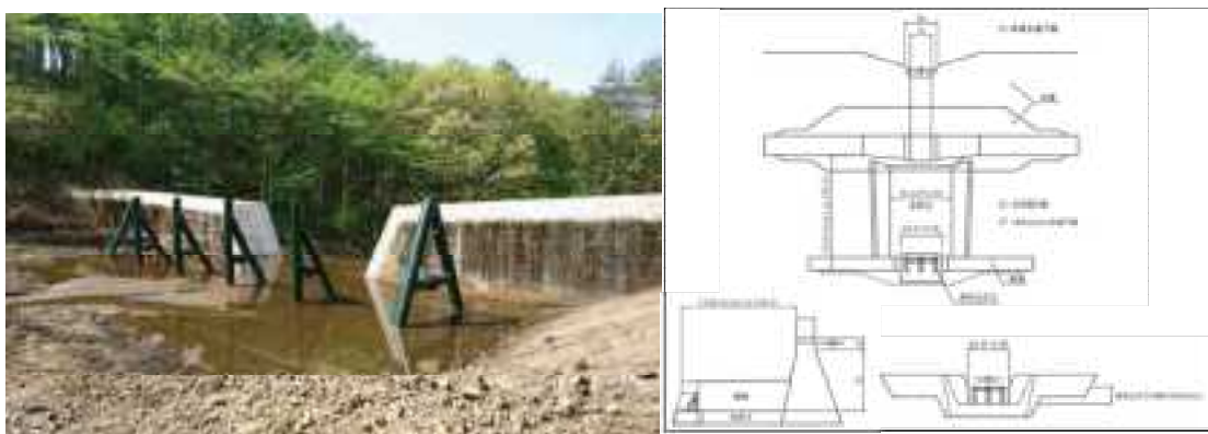
図 5.4 基本対策における流木対策（左：張り出し工施工例、右：流木止め付前庭保護工） （張り出し工：長井川砂防堰堤（利根川水系砂防事務所））
