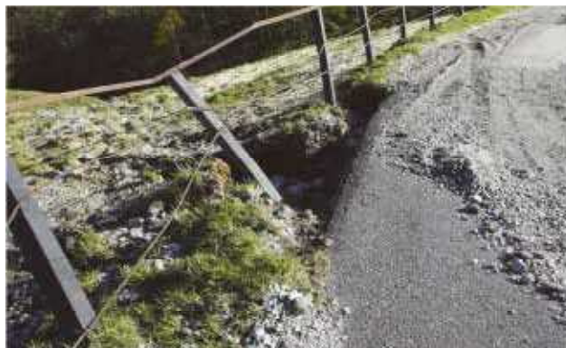
日光市 侵入道路及び牧柵の破損
