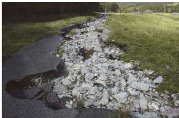
日光市 進入道路の破損
