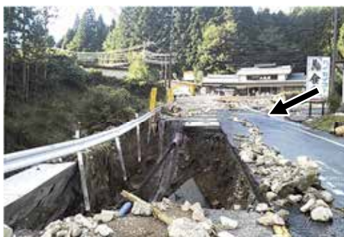
被災状況（日光市藤原 箒沢）
