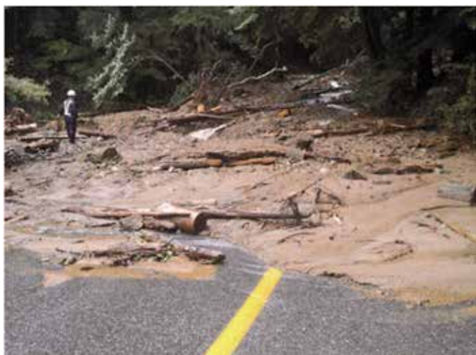
日塩有料道路 土砂流出状況
