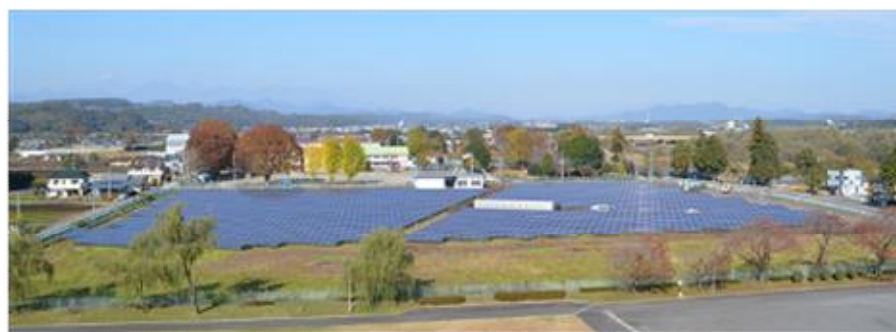
【太陽光発電施設】
