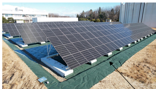
太陽光パネル近景
