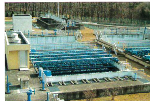
◇薬品沈でん池
