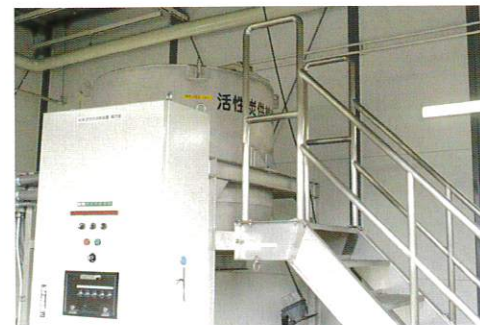
◇活性炭注入設備
