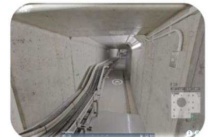
ケーブルダクト内
