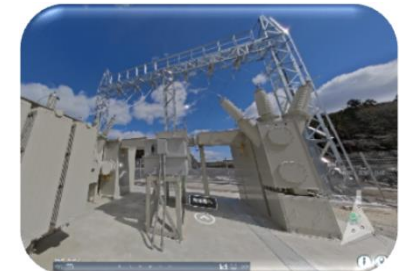
屋外変電所内
