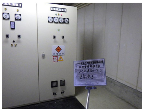
【高圧真空遮断器】
