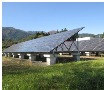
太陽光発電設備(北那須水道事務所)
