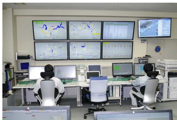
発電所の運転を行っている監視制御室（今市発電管理事務所）
