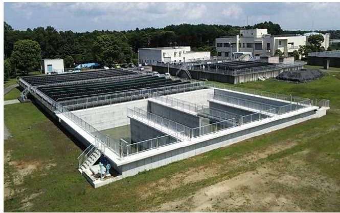
工業用水道施設（安定供給を図るためH26に配水池を増設）
