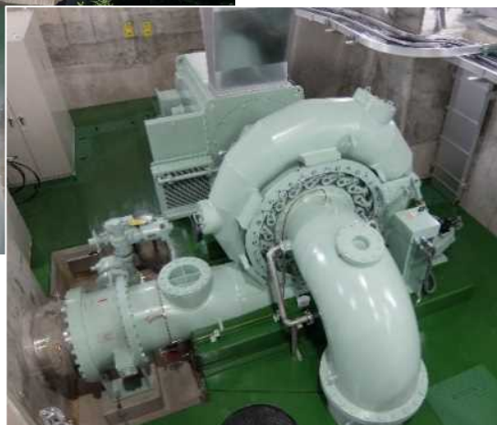
水車・発電機
