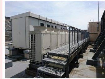
▲ 空調設備更新 (PAC※屋外機)
