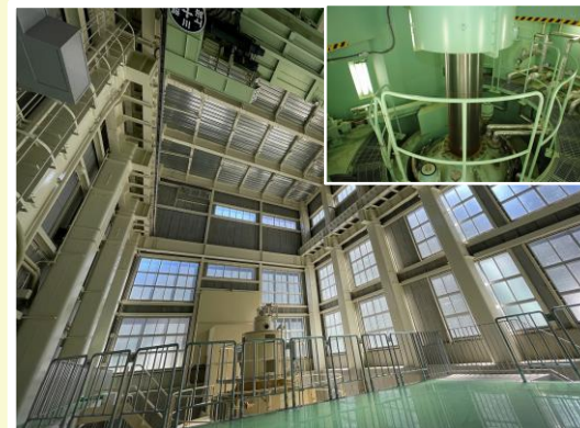
▲ 風見発電所 (FIT改修後)
