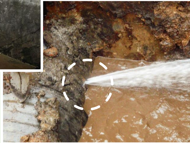
▶ 土壌腐食による配水管からの漏水
