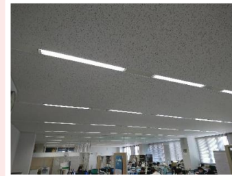
▲ 照明設備更新 (LED化)
