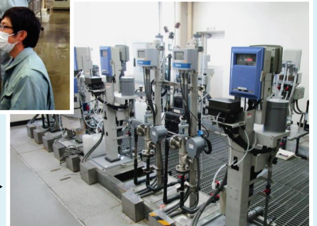
水質計器による常時監視 ▶
