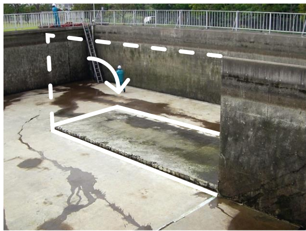
◀ 東日本大震災で倒壊した導流壁※ ※水流を安定させるための壁
