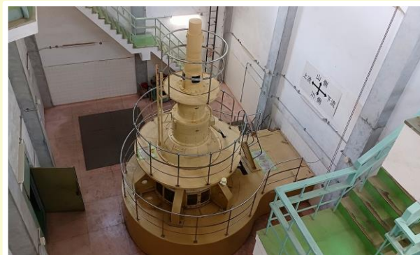
▲ 川治第二発電所
