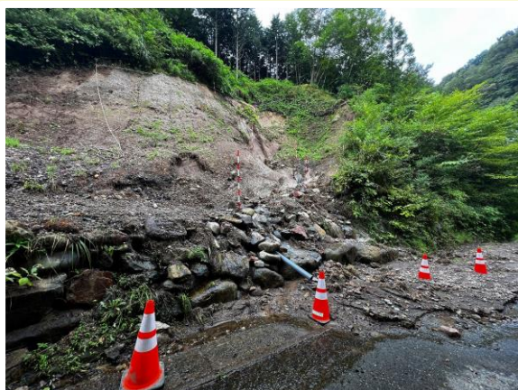
▲ 豪雨による土砂崩れ (東荒川発電所進入路)
