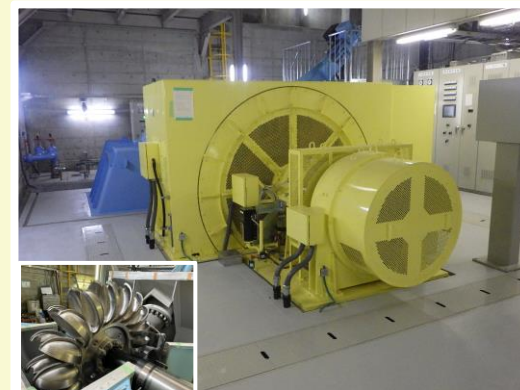
▲ 深山発電所 (FIT改修後)
