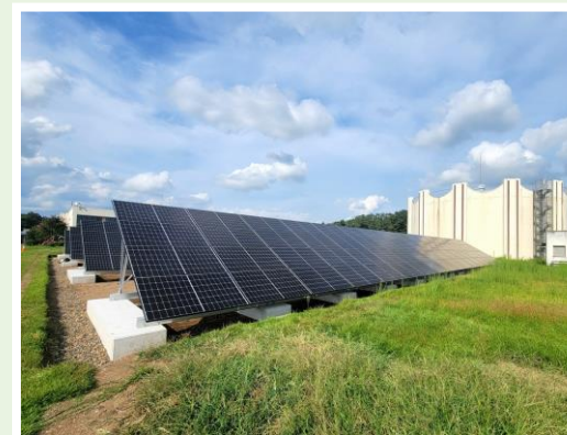
▼ 浄水場に設置した太陽光発電設備
