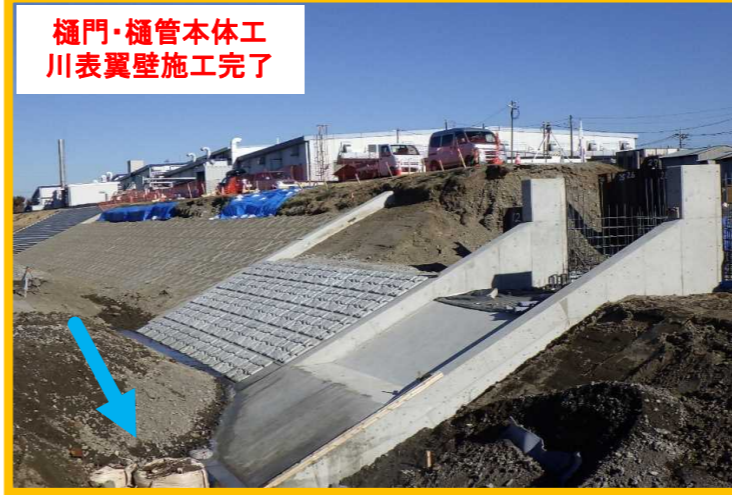
排水樋門改築工事その3 篠崎建設 樋門・樋管本体工:新しい計画にともない、樋門の改修を行います。
