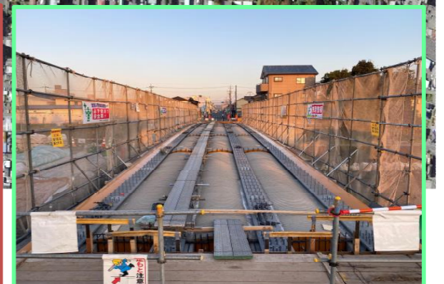
中橋上部工設置工事その6 川田建設株式会社 橋桁を施工するための足場を設置しています。
