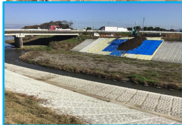
護岸工事その1 篠崎建設株式会社 工事用通路の盛土を行っています。
