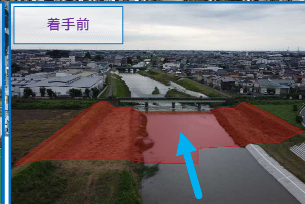
護岸工事その41 山菊開発(株) JRより上流の両岸の護岸工事を行います。(着色箇所)
