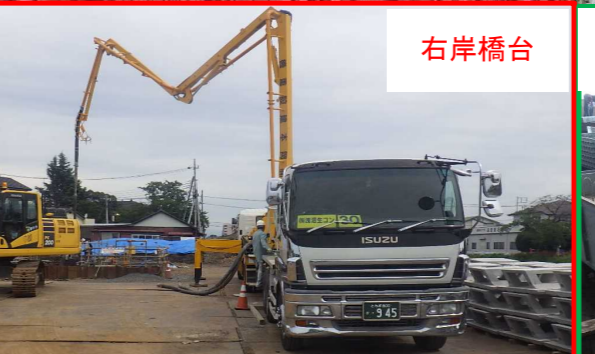
中橋下部工設置工事その5 山菊・朝日・篠崎特定JV 中橋右岸側の橋台の生コンクリートを打設しました。
