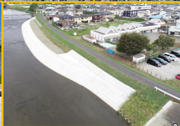
赤坂鷹部屋橋上流右岸 護岸工事 施工者 株式会社落合土木
