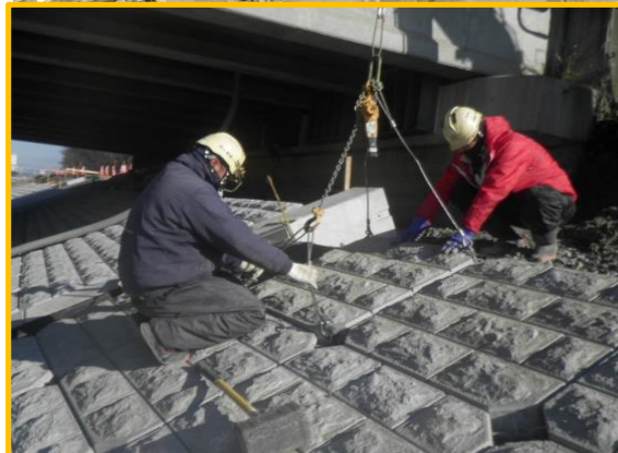
護岸工事その1 篠崎建設株式会社 大型ブロックの据付を行っています。
