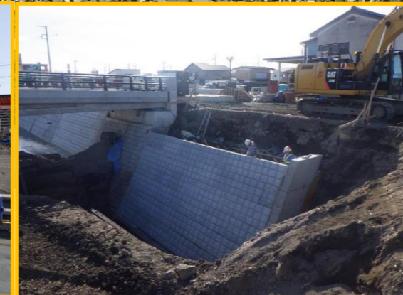
中橋下部工設置工事その5 山菊・朝日・篠崎JV 条件護岸部のブロックを据付しています。
