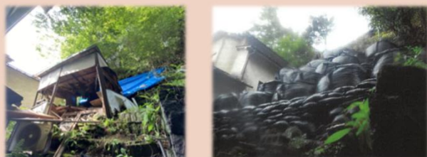
法面崩落後（左）と応急対策後（右）
