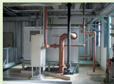
汚泥スクリーン・し渣脱水機
