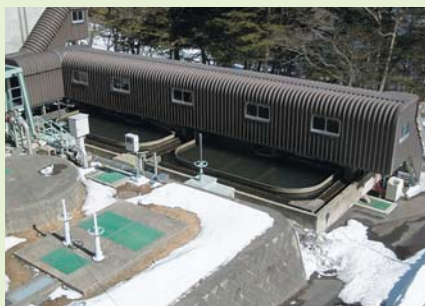
最終沈殿池①
