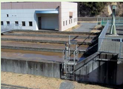
オキシレーションディッチ
