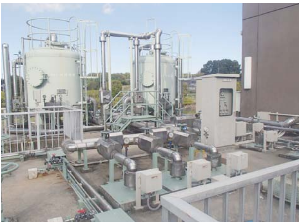
扶桑水処理センター塩素混和池
