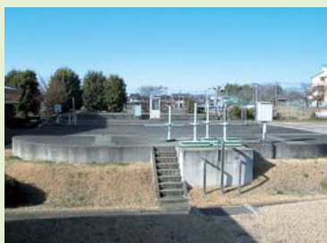
エアレーションタンク
