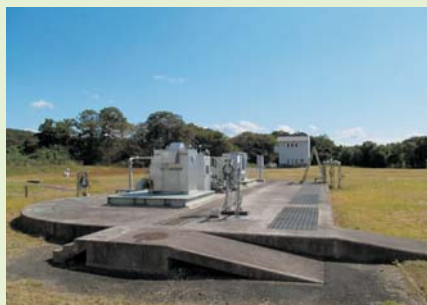
オキシレーションディッチ
