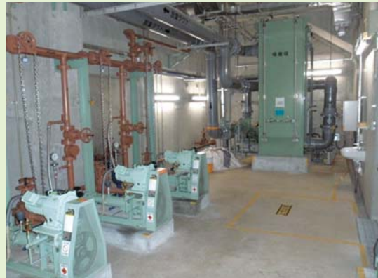
ブロワー施設
