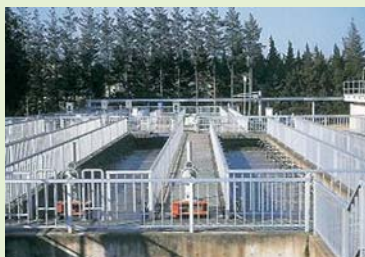
エアレーションタンク
