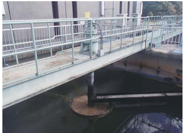
扶桑水処理センター最終沈殿池
