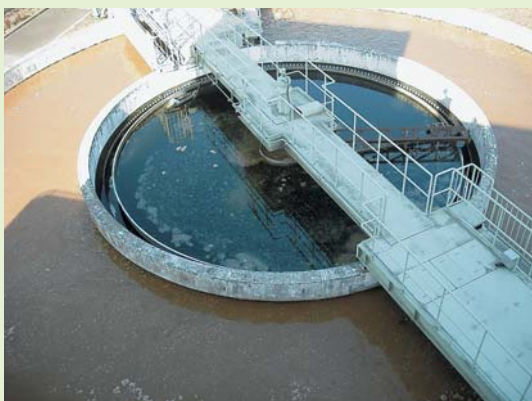
オキシレーションディッチ
