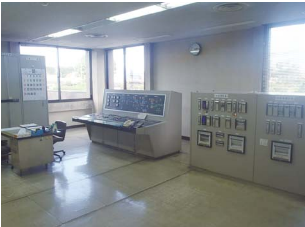
扶桑水処理センター操作室
