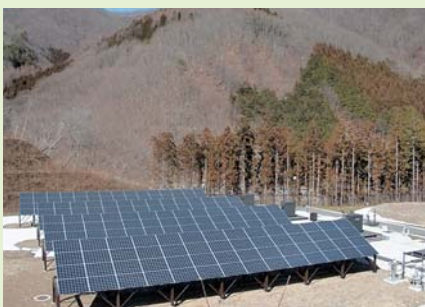
太陽光パネル
