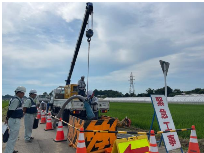
写真：下水道BCP合同訓練(右：対策本部の設置 左：現地での応急対応)
