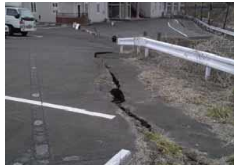
(b)のり肩の亀裂
