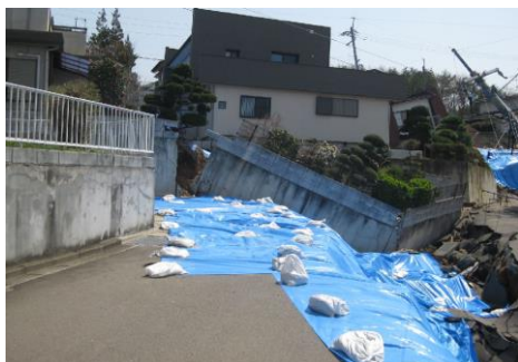
(c)腹付け盛土の崩壊
