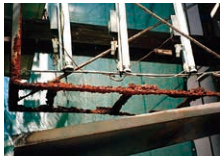
袖看板の底部脱落
