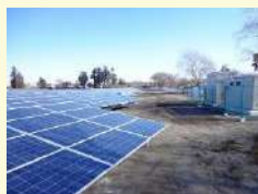
鹿沼市 太陽光発電所
