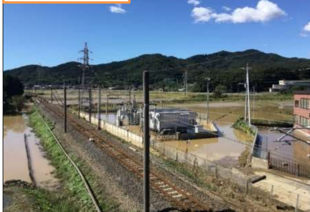
令和元年 被害状況
