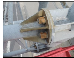
横梁ボルトの腐食 健全度Ⅱ
