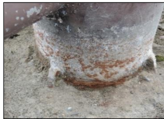
支柱根元の腐食状況
