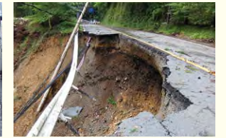
(国) 121号 藤原地区【被災状況】
