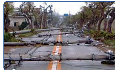
台風で倒壊した電柱
