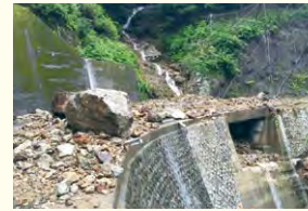
法面からの落石
