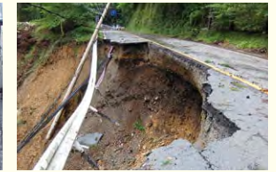
(国) 121号 藤原地区【被災状況】
