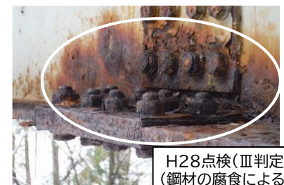
法定点検によって新たに確認された劣化例
