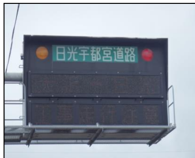
照度低下・通信不良
