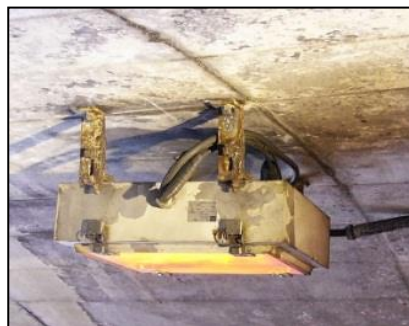
部品脱落・不点灯
