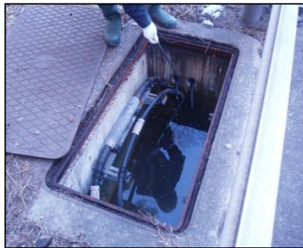
ハンドホール内が浸水
