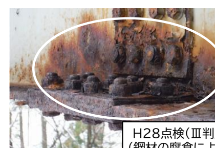
法定点検によって新たに確認された劣化例
