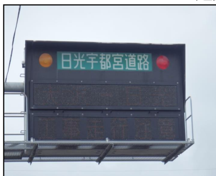
照度低下・通信不良
