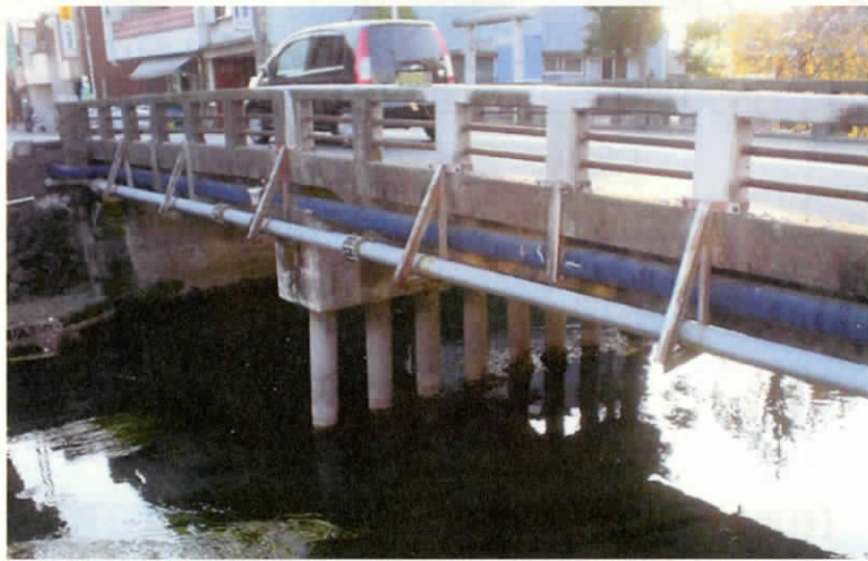
写真② 開明橋の老朽化状況
