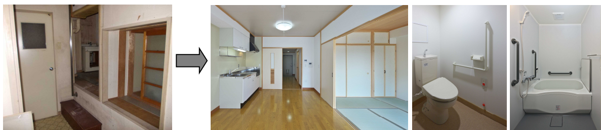
【整備前】 住戸内に大きな段差
