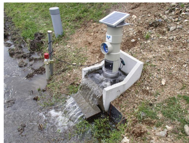
ICT自動給水栓
