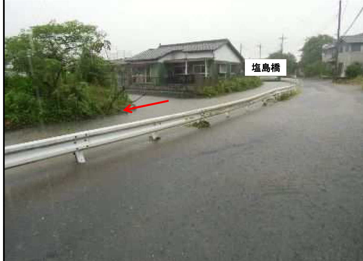
② 河道断面が狭小あるため溢水している
