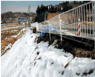
法面崩落による被災
