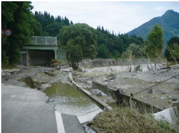
道路流出（国道252号）
