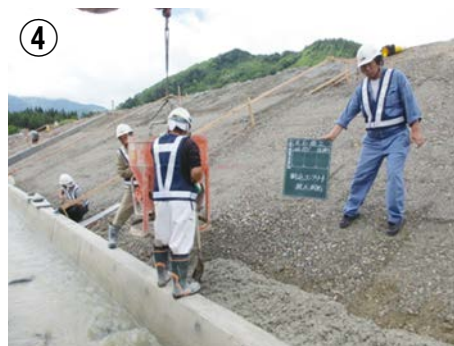
裏込砕石工を実施後、最下段の石の下側になる胴込コンクリートの打設
