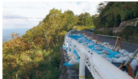
ブロック積み崩壊による片車線規制箇所
