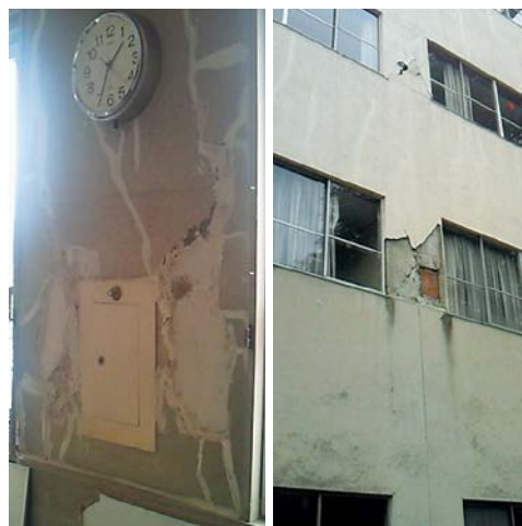
被災した東分庁舎（県北建設事務所）
