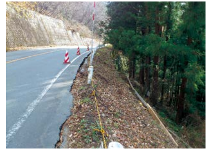
法面崩落による被災
