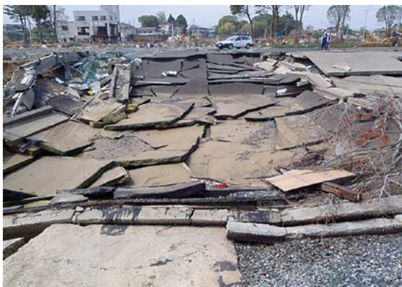
(隆起沈下、吸出、めくれなどの複合形態)
