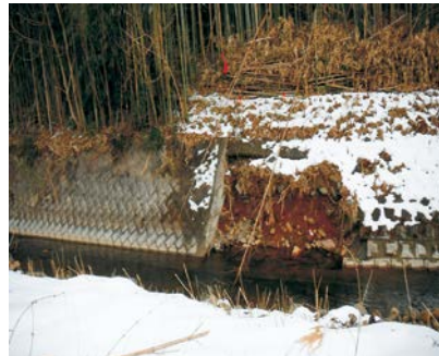
ブロック積みの崩落
