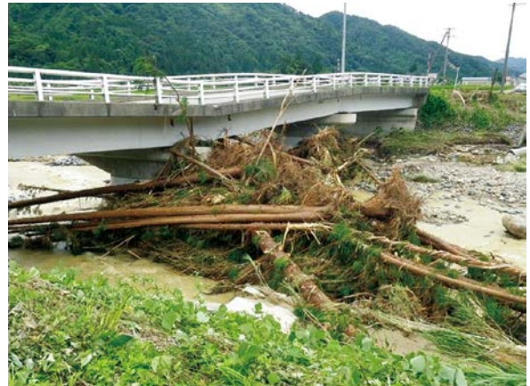
橋脚沈下（花立橋）
