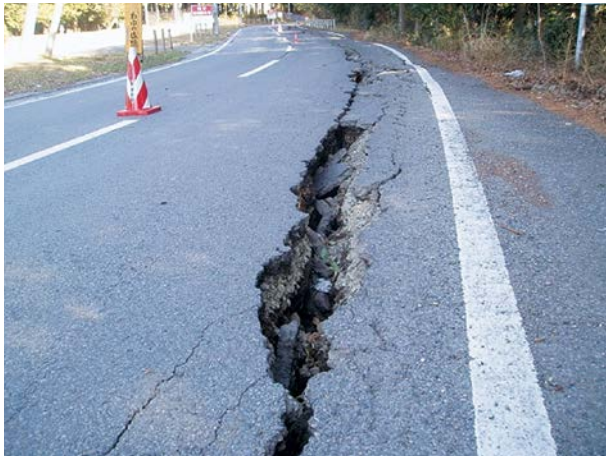
市道に発生した亀裂
