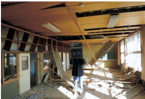
被害：天井・壁材等の破損・落下
