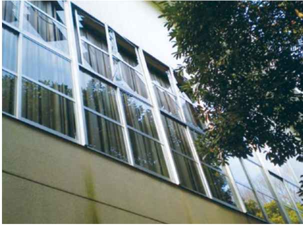
窓ガラスの破損状況
