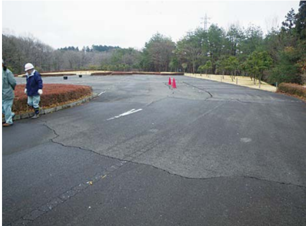
路面の亀裂状況
