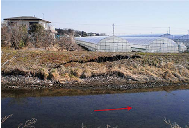
堤防に発生した亀裂
