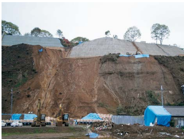
斜面崩壊発生状況
