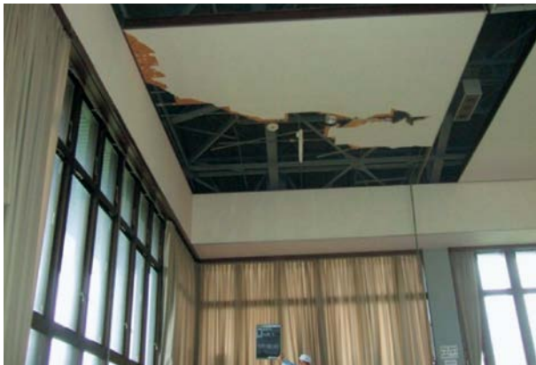
被害：天井材の破損・落下
