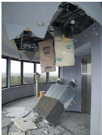
空調器及び天井落下
