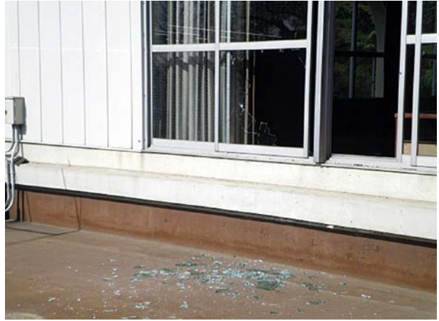
落下飛散状況
