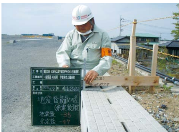
真岡宇都宮バイパス 側溝の不等沈下
