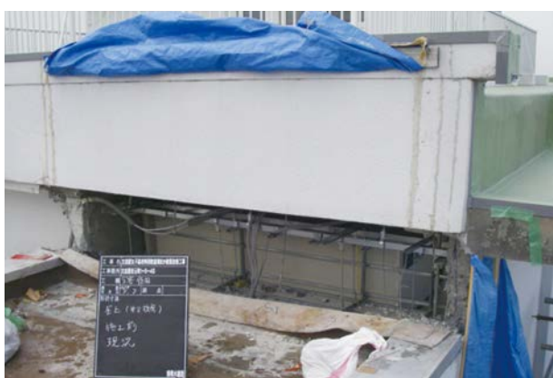
被害：CB壁、防水シートの破損
