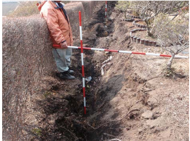
斜面上部亀裂
