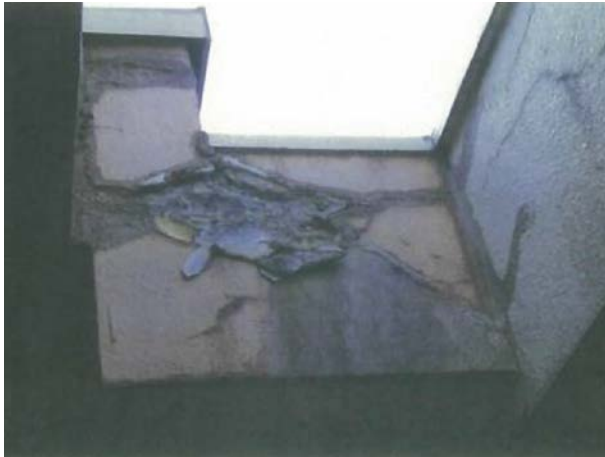
外壁浮き状況
