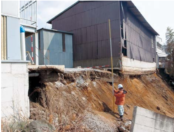
斜面崩壊により傾いた家屋
