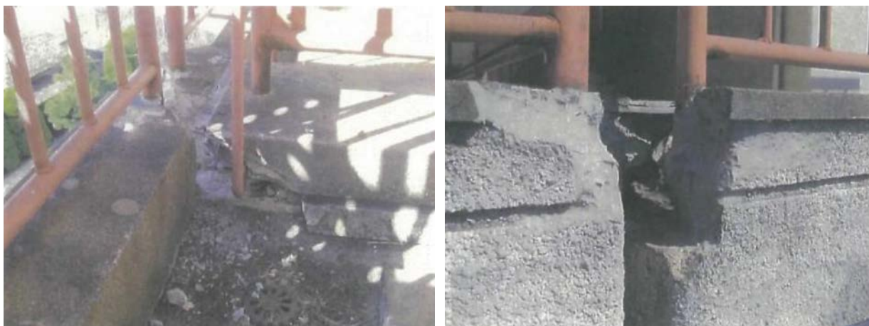
バルコニー外壁立上り部破損状況
