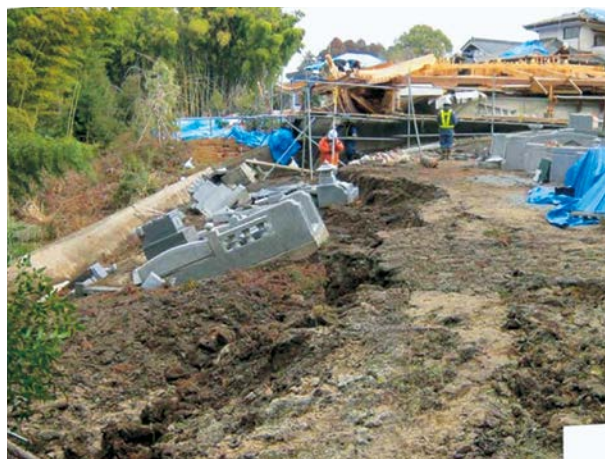
台地上の段差亀裂
