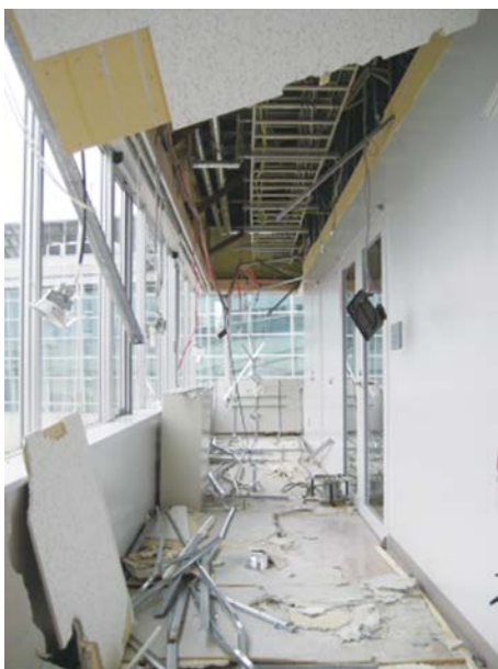
被害：天井材の破損・落下
