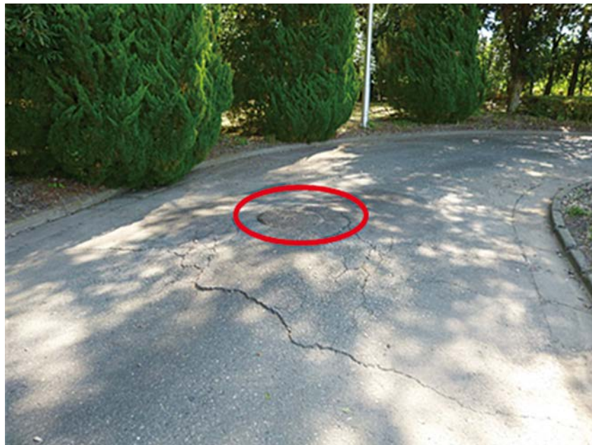
舗装の被災状況
