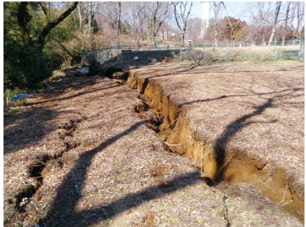
斜面上部に発生した亀裂、段差
