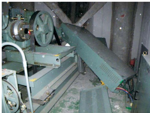
エレベーター室機器の転倒
