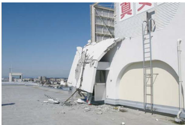
被害：壁材の破損・落下
