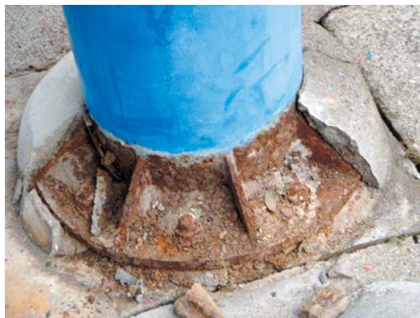
構造物基礎の破損
