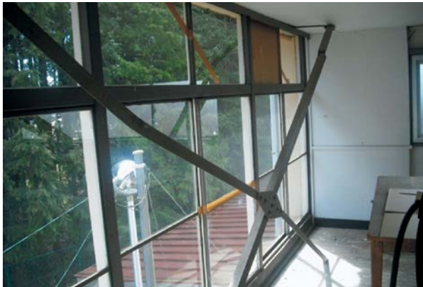
被害：鉄骨ブレース座屈
