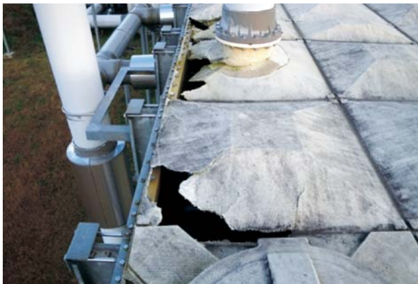
被害：受水槽パネル破損
