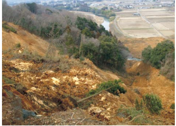
崩落した斜面
