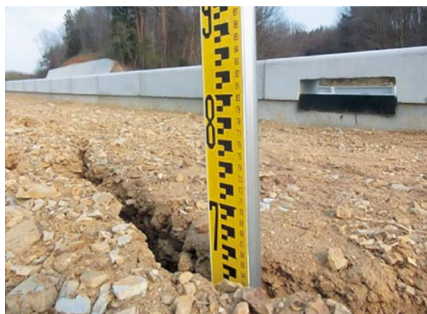
芳賀市貝バイパス 路体クラック
