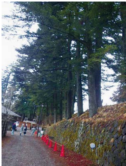
石積みのはらみ
