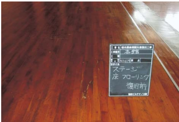
被害：天井材落下によるフローリング板の損傷
