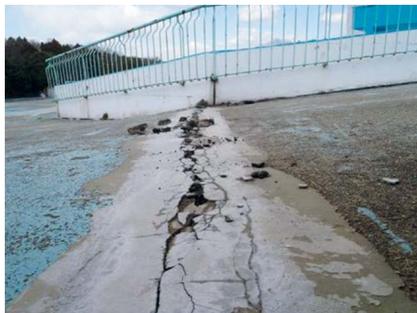
床面に発生した亀裂
