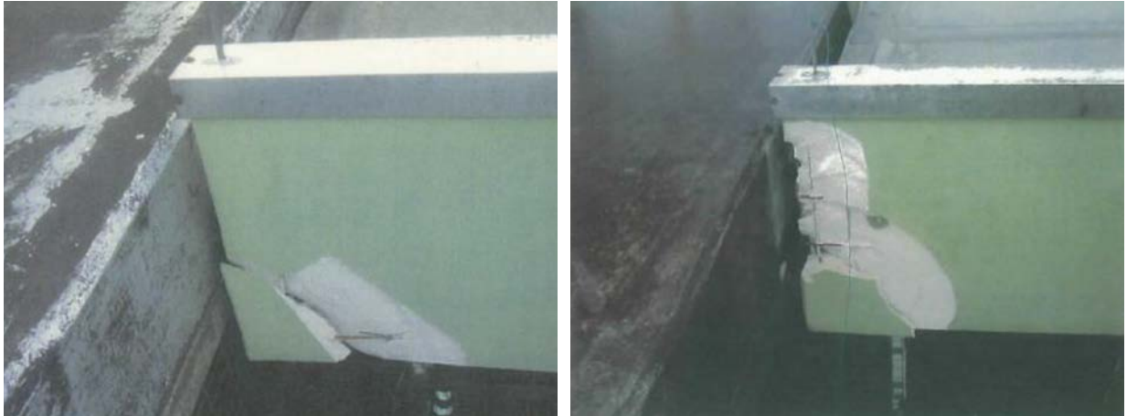
羽川住宅6号棟及び7号棟外壁一部落下状況
