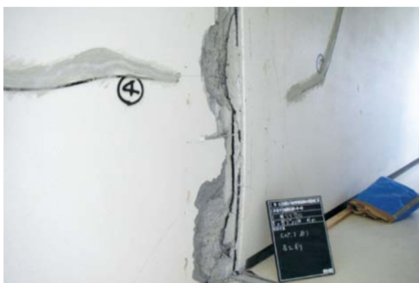
被害：エキスパンションジョイントのクリアランス不足による壁躯体はらみ・破損
