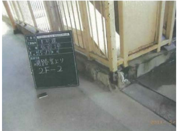
手摺足元コンクリート破壊状況
