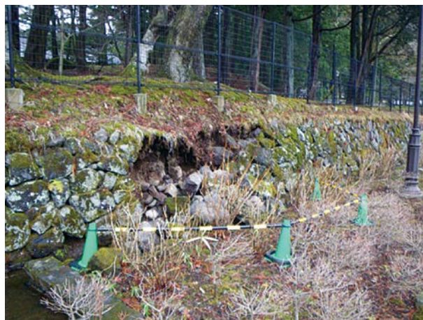
一部崩壊状況
