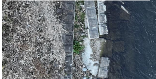
UAV点検により新たに確認された変状
