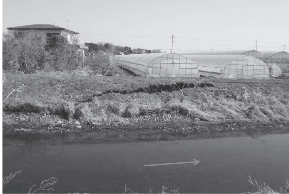
写真14-3-7 被災状況 左岸の土羽護岸が23.7mにわたり崩落
