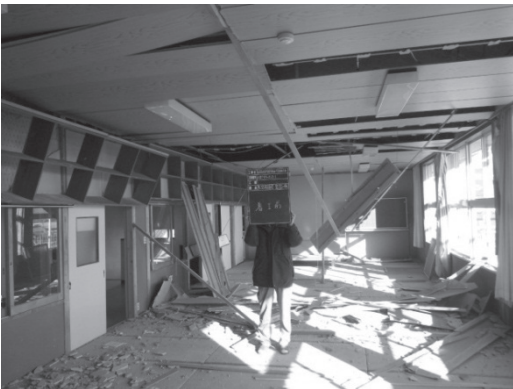
写真 14-3-14 被災状況 （天井、壁材等の破損）
