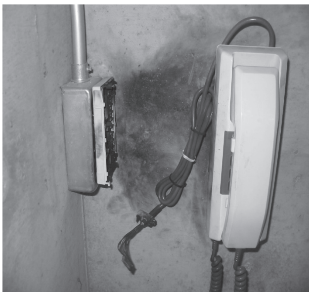
図14-3-10 送受信所内インターフォンの損焼状況
