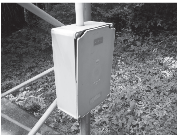
図 14-3-14 試験端子箱損傷状況
