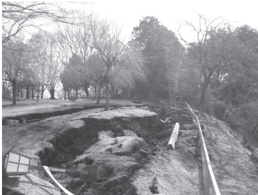
写真14-3-9 震災による被災状況
