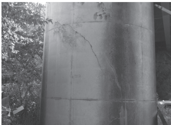
図14-3-5 被災状況(P6橋脚)
