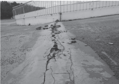
写真 14-3-12 被災状況 （床面に発生した亀裂）
