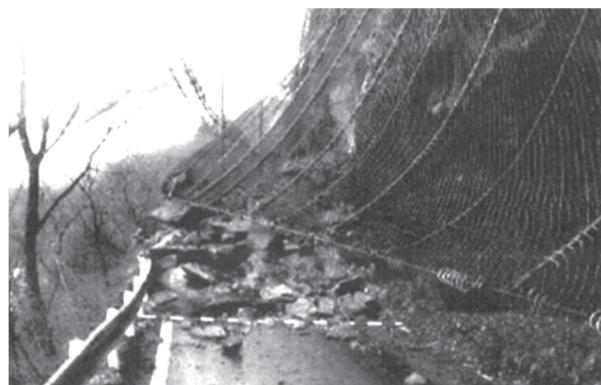
図2-6-66 平成14年 工区内旧道での土砂崩れ (通行止め22日間)
