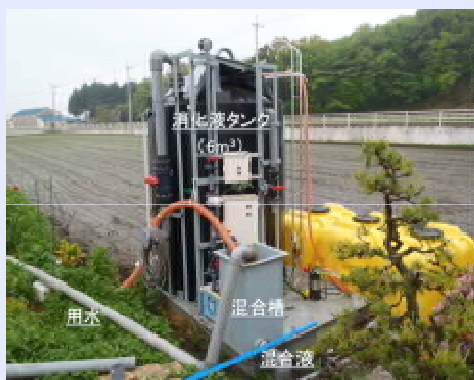
水田に設置された消化液散タンク
