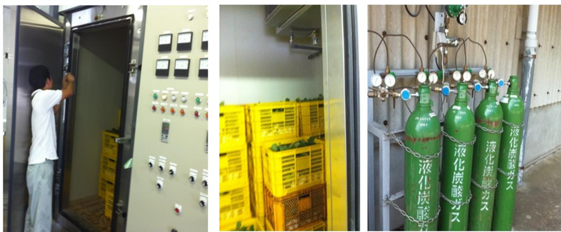
・くん蒸処理装置前面の様子 ・処理装置庫内の様子 ・くん蒸処理用CO 2 ボンベ
