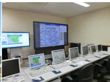
待矢場両堰土地改良区内の水管理システム
