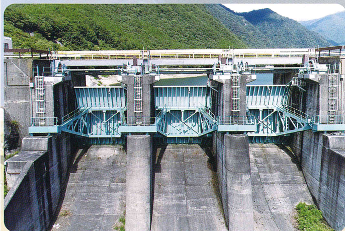
余水吐(ラジアルゲート3門)
