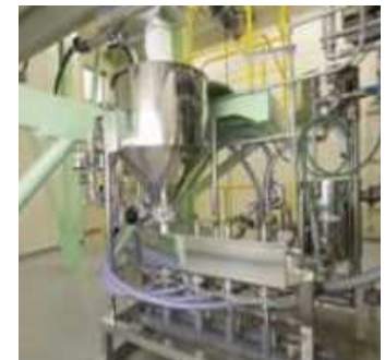
米粉粉碎施設
