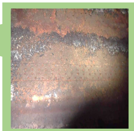
錆がひどく老朽化が深刻...
