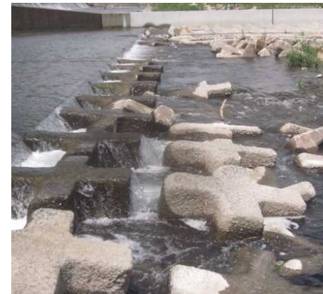
( 転倒・沈下している護床工 )
