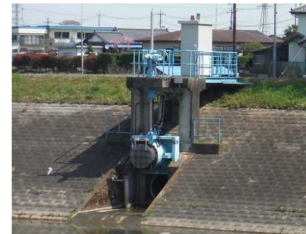
(上流に設置されたポンプゲート)
